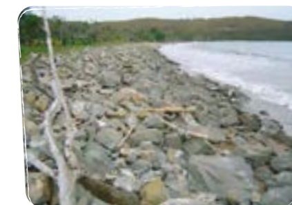
Dégradation des habitats (ex : enrochement)
